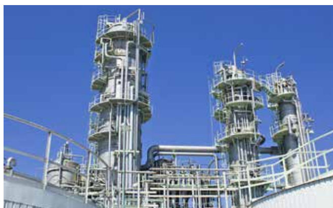
トール油精留プラント（2025年現在）
