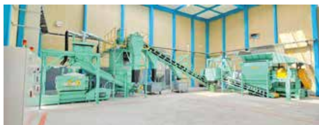
RPF事業部（神崎郡市川町）の破碎・成形処理設備
